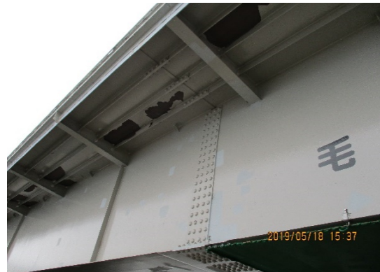
拡幅増設桁（一主鋼床版張出デッキプレート）の表層部塗面剥離損傷が見られた
